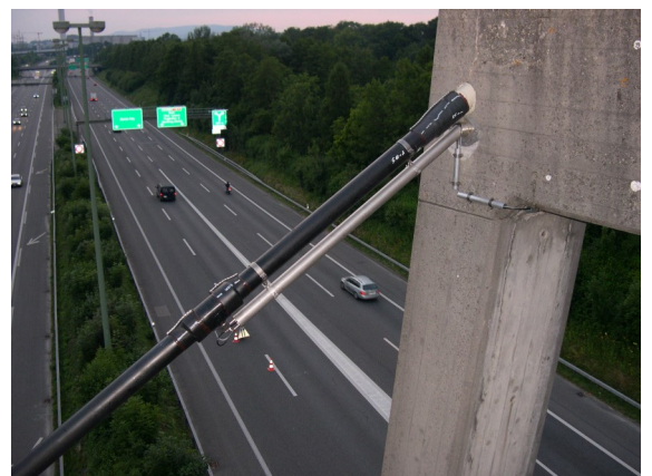
Kopfbereich der Schrägkabel mit installiertem Messgeber
